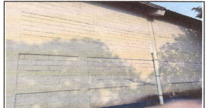
Foto 4: Bajadas de agua en mal estado, rotos e incompletos.
