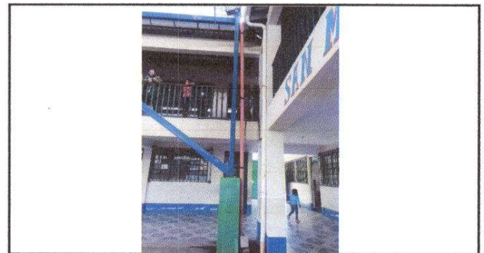
Foto 6: Bajadas de agua en mal estado, rotos e incompletos.
